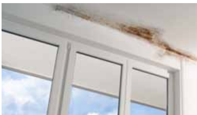
Augmentation du risque de colonisation de moisissures
