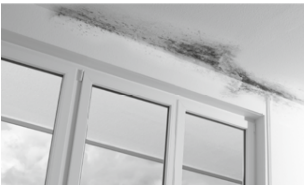
Augmentation du risque de colonisation de moisissures
