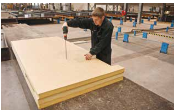
Étape 1 : Préforage de trous dans la couche isolante pour y insérer les tiges Isolink.
