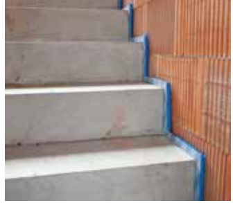
Ill. 8: Exécution correcte – le Schöck Tronsole® sépare les éléments de construction en entier et minimise le risque de ponts acoustiques.
