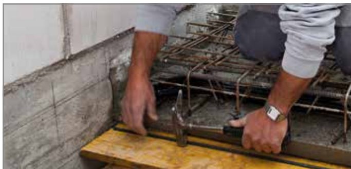
Ill. 89: Poser la latte cloutée inférieure, respecter un écart de \geq 40 \text{ mm} par rapport à l'élément préfabriqué
