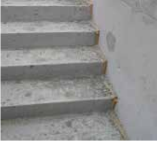
Ill. 7: Exécution défectueuse – des matériaux trop mous constituent un risque de ponts acoustiques (des cailloux qui s'incrudent pendant l'avancement des travaux).
