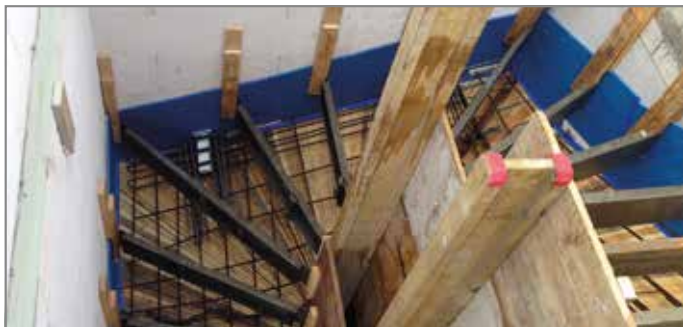
Ill. 132: Renforcer la volée d'escalier et poser les planches pour les marches
