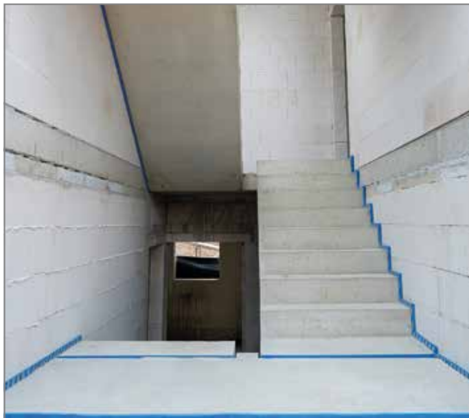
Ill. 52: La ligne bleue est un signe de qualité d'installation certifiant l'absence de ponts acoustiques et garantissant une protection acoustique sûre
