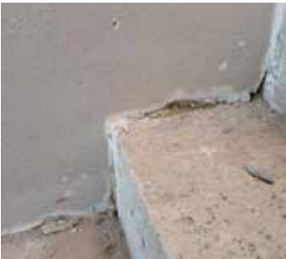
Ill. 3: Exécution défectueuse – pont acoustique créé par les travaux de second oeuvre
