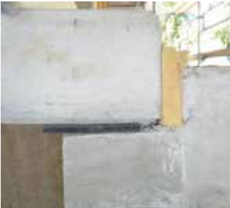
Ill. 1: Exécution défectueuse – pont acoustique créé par des solutions de chantiers incomplètes
