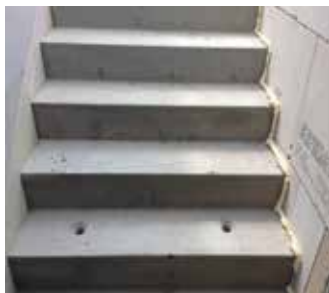
Ill. 5: Exécution défectueuse – des matériaux trop durs peuvent conduire à une nette détérioration de l'isolation acoustique.
