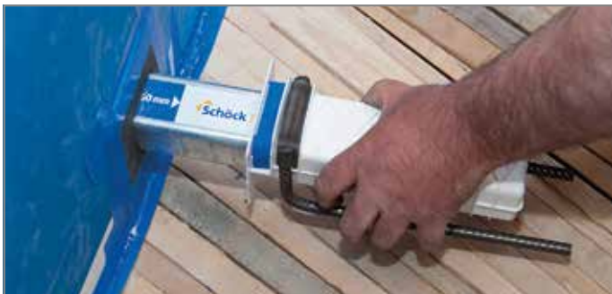
Ill. 71: Enficher la gaine et protéger les joints de la laitance du béton
