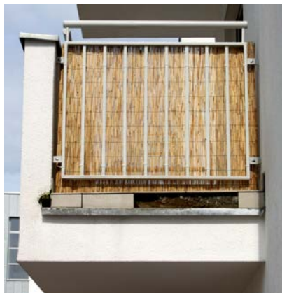
Fot.1 Uszkodzenia balkonów izolowanych styropianem
