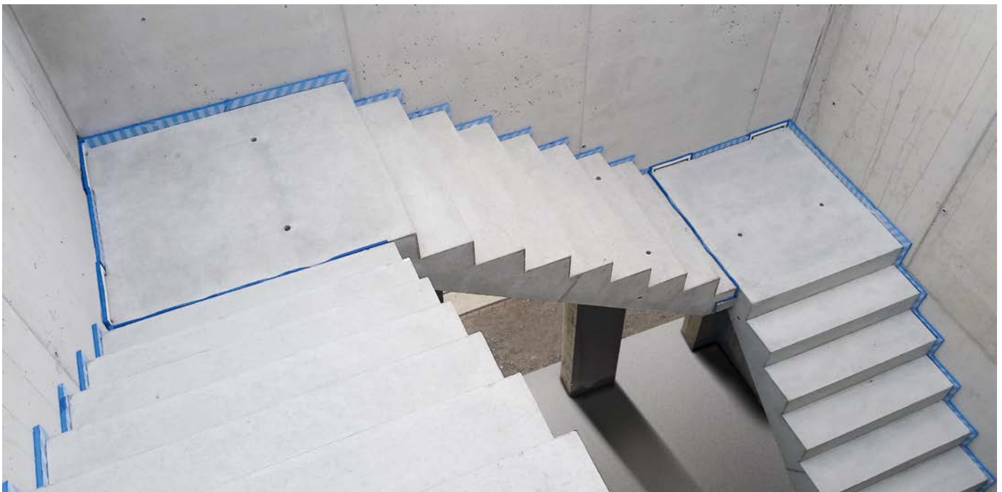
Abb. 15: Die blaue Linie zeigt den schallbrückenfreien Einbau als Qualitätsmerkmal für einen sicheren Trittschallschutz.
