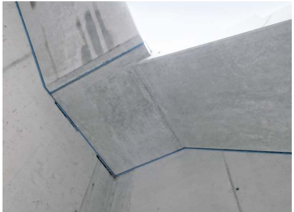
Abb. 14: Durchgehende blaue Linie im Fugenbereich
