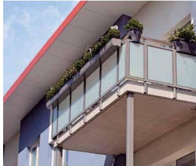
Bei der Komplettsanierung eines Wohnhauses in Bochum wurden die Balkone mit Schöck thermisch entkoppelt.
